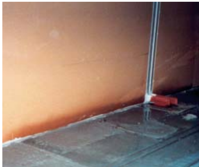
Kipsilevyväliseiniä on asennettu ennen kuin veden valuminen välipohjille on estetty. Jo asennettuja kipsilevyjä jouduttiin tällä työmaalla vaihtamaan satoja neliömetrejä. Suojausten ja veden- poistojen suunnittelu sekä asennustyön aikatauluuttaminen olisivat säästäneet huomattavasti kustannuksia.
