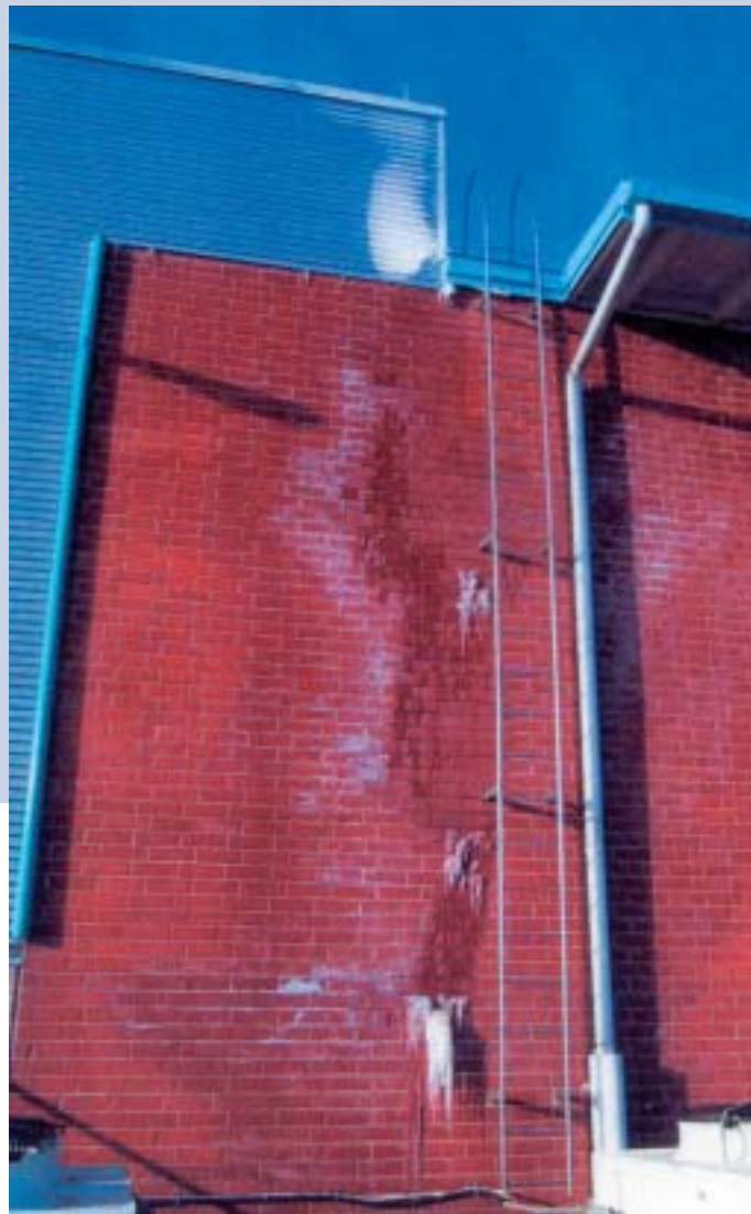
Korkea sisäilman suhteellinen kosteus ja puutteellinen höyrynsul- ku ovat aiheuttaneet teollisuusrakennuksen ulkoseinän kastumi- sen ja jäätymisen. Vaurio olisi vältetty, jos suunnittelussa, rakennustyössä ja valvonnassa olisi osattu kiinnittää höyrynsul- kurakenteiden toimivuuteen riittävästi huomiota.
